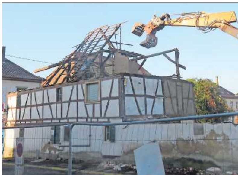
Zerstört trotz prominenter Fürsprache: Haus Greder in Geudertheim. FOTO: ASMA
