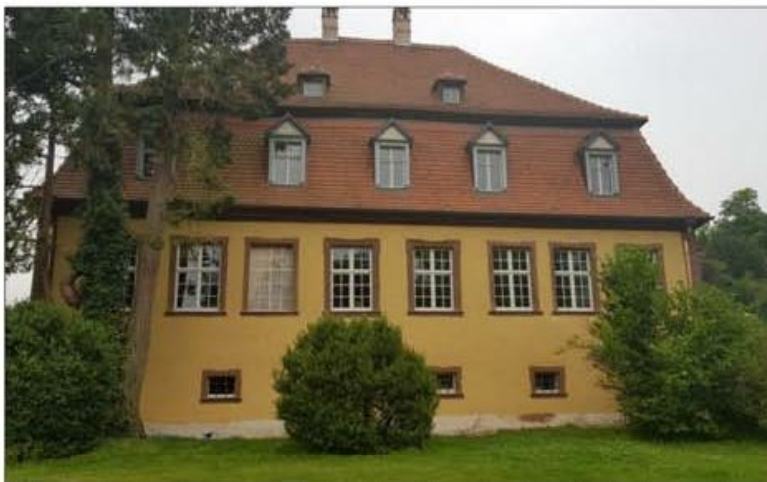
Les travaux de la façade sont presque terminés : lors de la construction du bâtiment, pour préserver sa symétrie, une fausse fenêtre avait été peinte en trompe-l'oeil. Photo DNA/Léa SCHNEIDER
